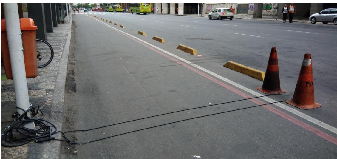
Figura 1 - Contador instalado na Av. Amaral Peixoto
